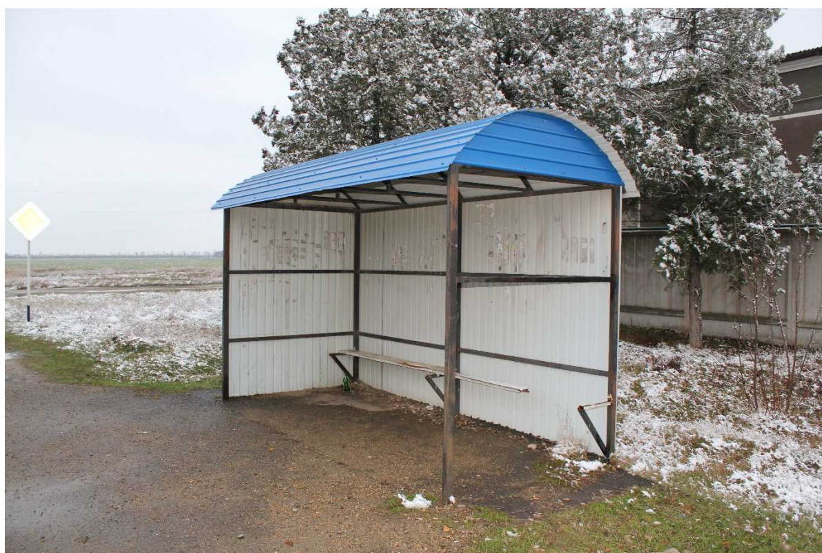
Внешний вид и состояние инфраструктуры остановки № 48
