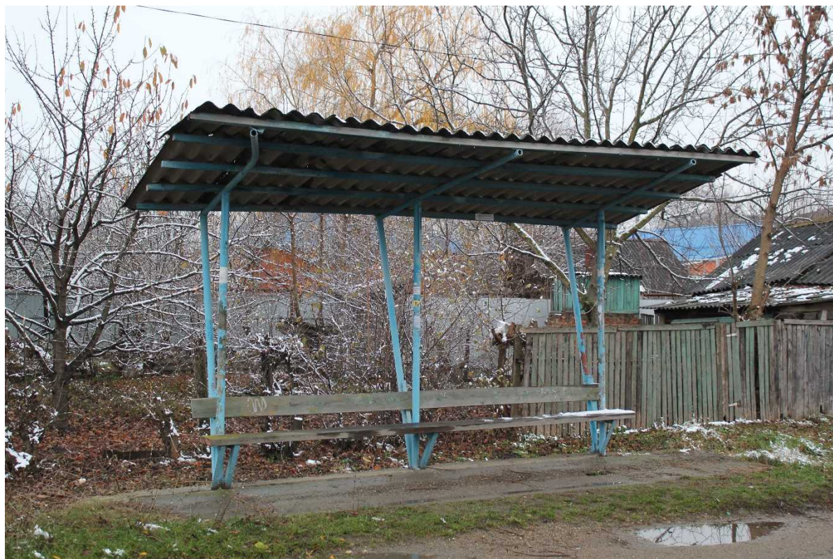
Внешний вид и состояние инфраструктуры остановки № 50
