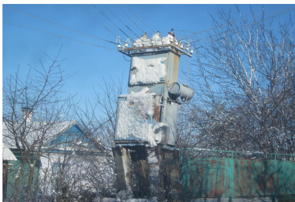
Трансформаторная подстанция – 100 кВт. ул.Терешковой. Стоит криво. Подвод на скрутках. Трансформатор ржавый. Замаслен. Надписей нет.
