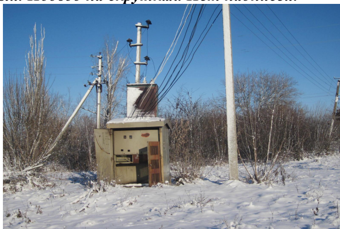
Трансформаторная подстанция – 100 кВт. ул.Мира. Надписей нет. Ржавый.
