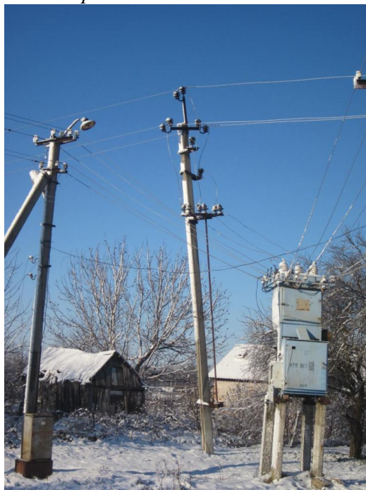
Опора линии электропередач. Столб кривой.
