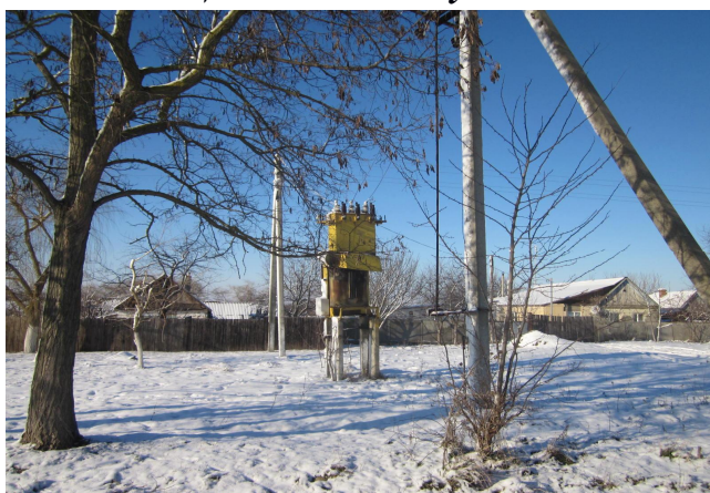
Трансформаторная подстанция – 100 кВт. с.Нижний Айрюм. Ул.Ковылкова. Трансформатор ржавый. Надписей нет.
