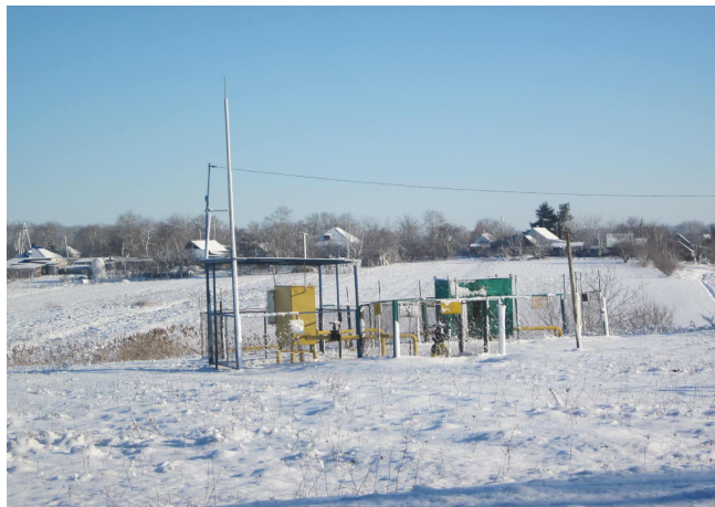
Газораспределительная станция. с. Нижний Айрюм.
