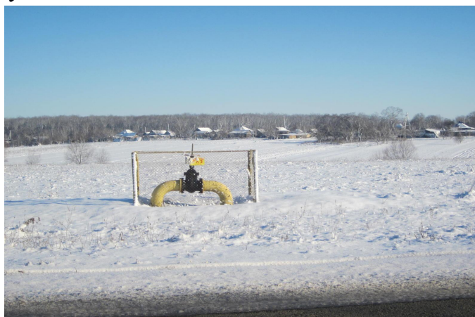
Газовый узел. с.Нижний Айрюм.
