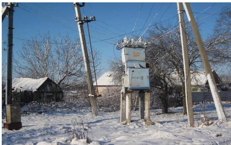
Трансформаторная подстанция – 100 кВт. х.Красный Хлебороб.ул.Центральная. Стоит с наклоном 3°. Надписей нет. Подвод на скрутках.
