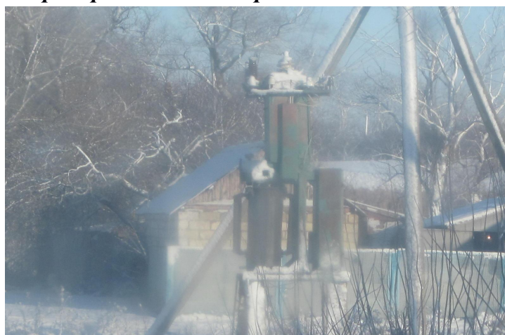
Трансформаторная подстанция – 100 кВт. Стоит под углом 4°. Нет надписей. Трансформатор ржавый.
