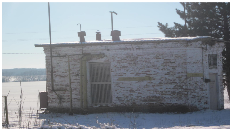
ГРП. п.Новый. ул.Набережная. Нет надписей. Необходимо покрасить.
