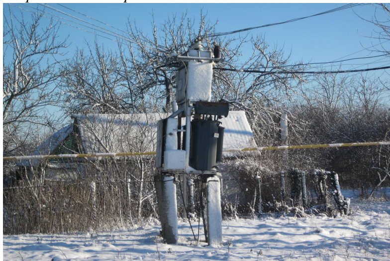
Трансформаторная подстанция – 100 кВт. с.Образцовое. ул.Полевая. Стоит под углом. Ржавый.
