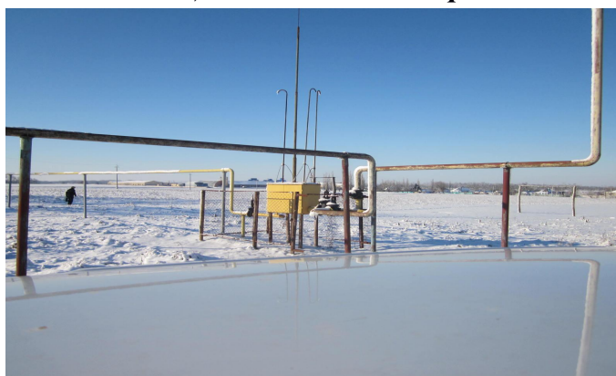
ГРПШ. с.Образцовое. ул.Зеленая. Нет надписей. Газопровод не покрашен.
