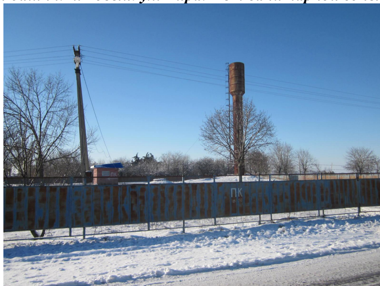
Водонапорная башня. п.Новый. ул.Западная. Ржавая.
