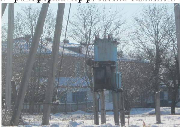
Трансформаторная подстанция – 100 кВт. ул.Мира. Трансформатор замаслен. Ржавый. Подвод на скрутках. Нет надписей.
