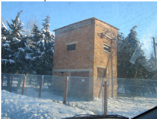
Трансформаторная подстанция – 100 кВт. ул.Школьная. Надписей нет.
