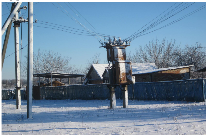
Трансформаторная подстанция – 100 кВт. с.Нижний Айрюм. ул.Зеленая. Не покрашен. Надписей нет.
