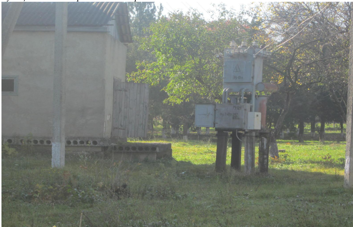
Трансформаторная подстанция – 100 кВт. Отсутствуют необходимые надписи. Трансформатор замазлен. Ржавый.
