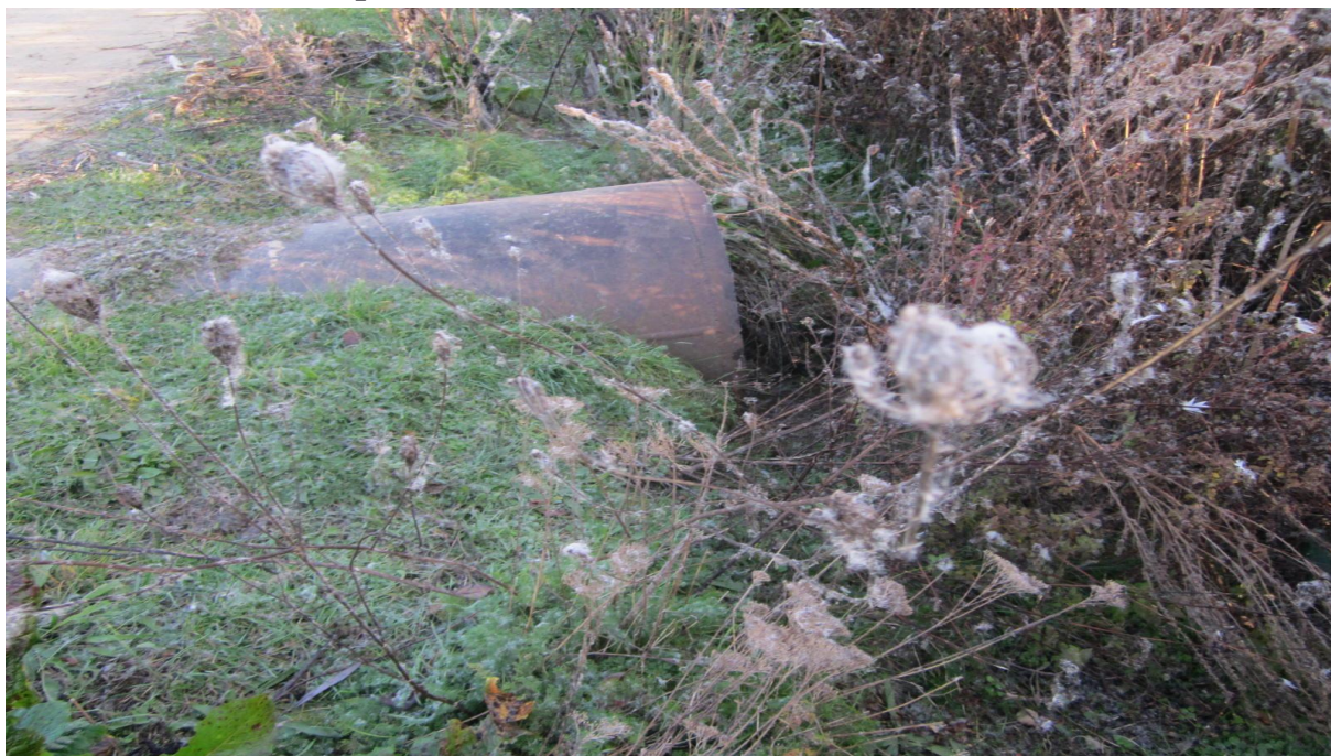
Водоотведение.х.Тамбовский. Труба заросла травой.
