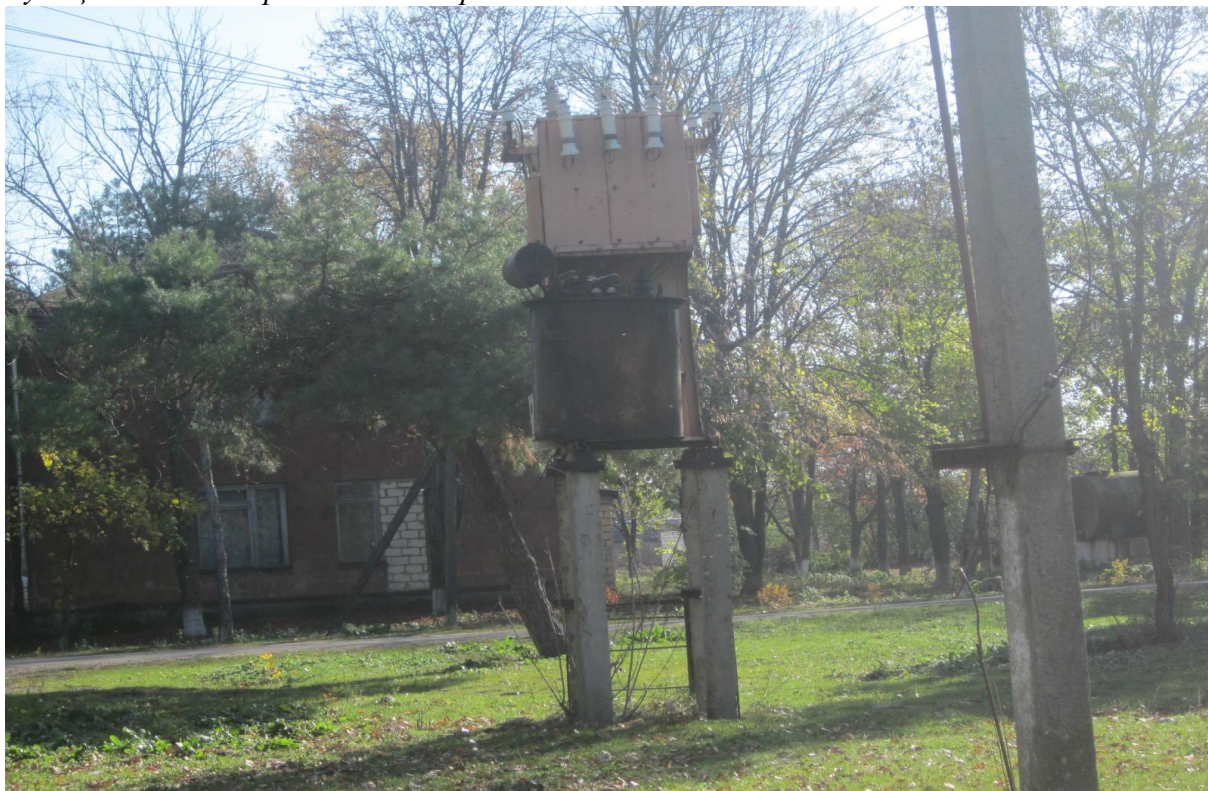
Трансформаторная подстанция – 100 кВт. ул.Почтовая и Центральная. Трансформатор замаслен. Нет необходимых надписей.
