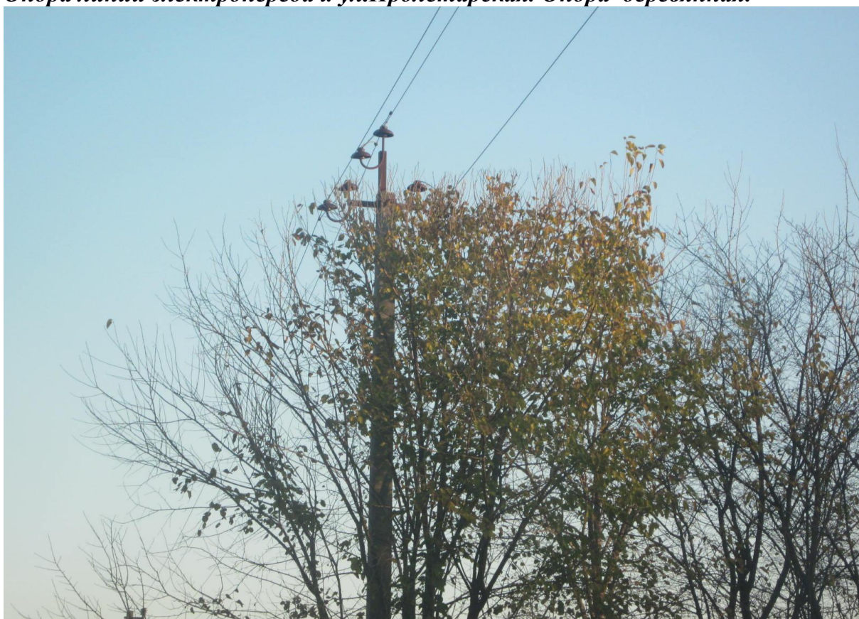
ЛЭП-10 кВт. ул.Пролетарская, 46. Провода в деревьях.
