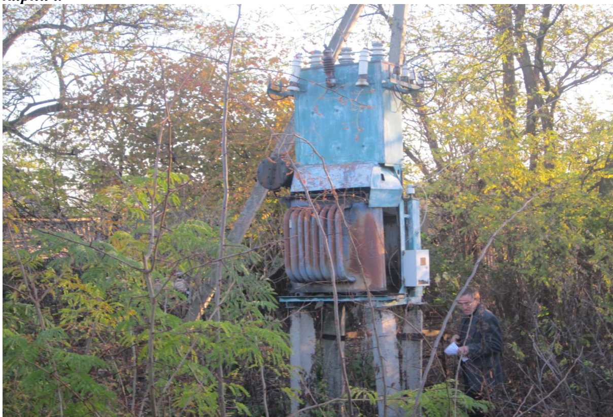
Трансформаторная подстанция-100 кВт. ул.Пионерская, 22. Трансформатор стоит в деревьях. Ржавый. Отсутствуют необходимые надписи. Все железные принадлежности сильно ржавые.
