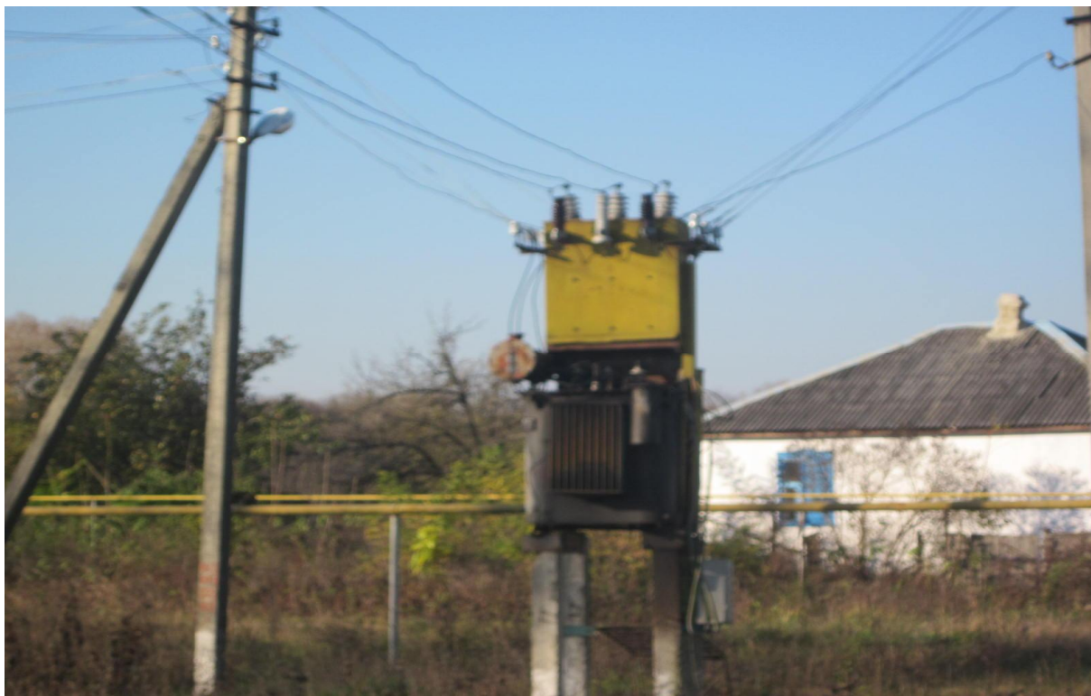
Трансформаторная подстанция – 100 кВт. х.Екатериновский. ул.Пионерская. Трансформатор замаслен. Скрутки. Надписей необходимых нет.
