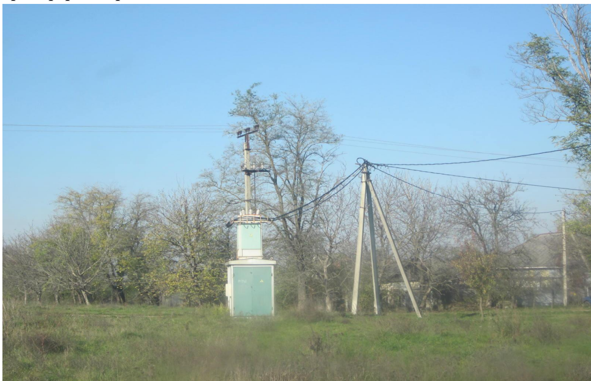
Трансформаторная подстанция – 100 кВт. ул.Октябрьская. Трансформатор новый. Один на все поселение.
