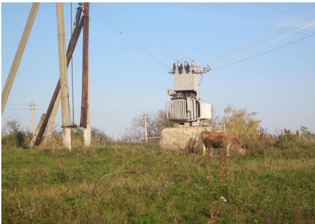
Трансформаторная подстанция – 100 кВт. ул. Степная. Трансформатор ржавый. Разъединители ржавые. Надписей необходимых нет. Столб деревянный.
