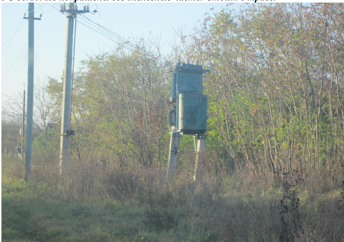
Трансформаторная подстанция-100 кВт. ул.Прямая. Трансформатор стоит под углом 6°. Надписей нет. Трансформатор ржавый.
