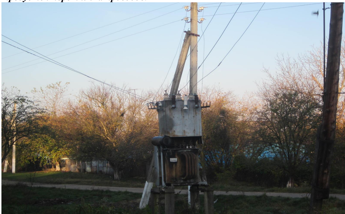
Трансформаторная подстанция – 100 кВ. ул.Пролетарская и Красных Партизан. Трансформатор замаслен. Ржавый. Скрутки на ЛЭП. Опора деревянная. Нет кожуха. Нет надписей.
