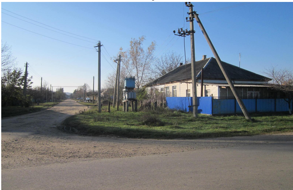
Трансформаторная подстанция – 100 кВт. х. Тамбовский. Ул.Красная. Нет кожуха. Отсутствуют необходимые надписи.
