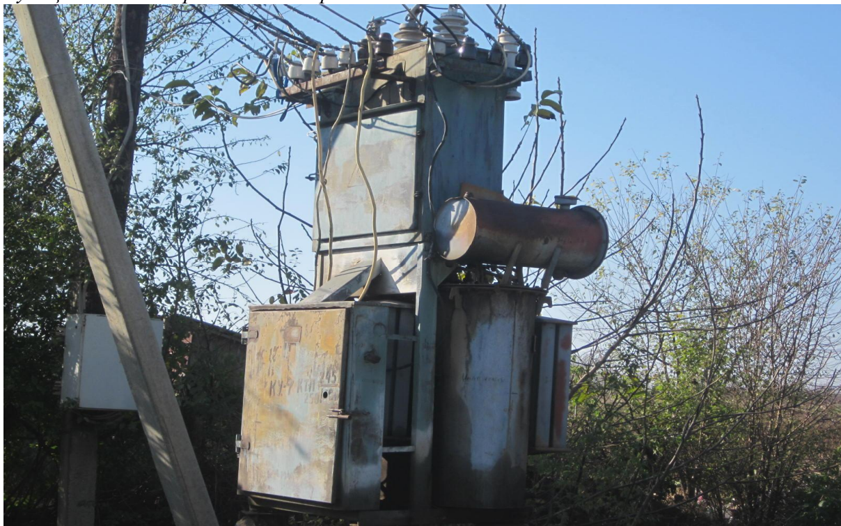
Трансформаторная подстанция – 100 кВт. с.Сергиевское. ул.Кузьмечная и Центральная Трансформатор замаслен. Ржавый. Замаслен. Необходимых надписей нет.
