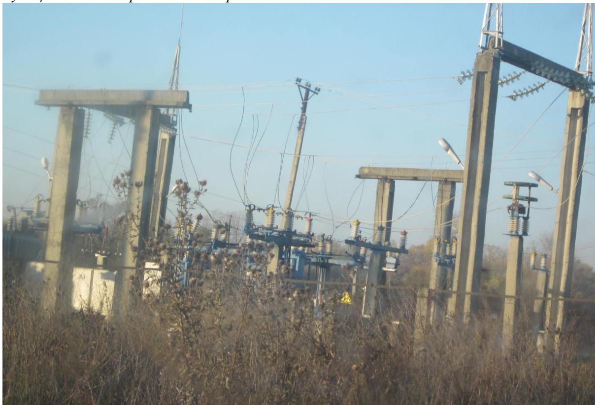
ПС-35/10. Не покрашены все железные часть. Стоит в траве.
