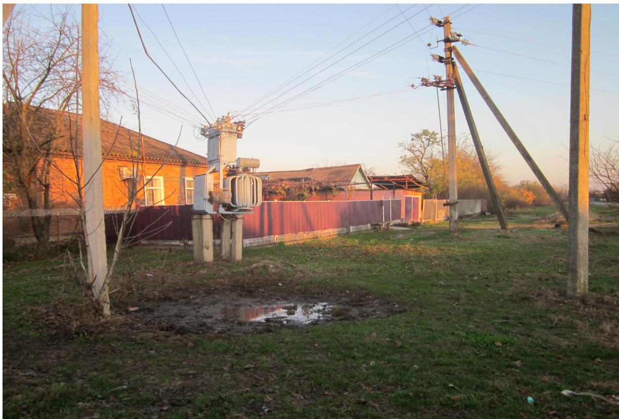
Трансформаторная подстанция-100 кВт. с.Сергиевское. ул.Кузнечная, напротив дома №17. Нет надписей.
