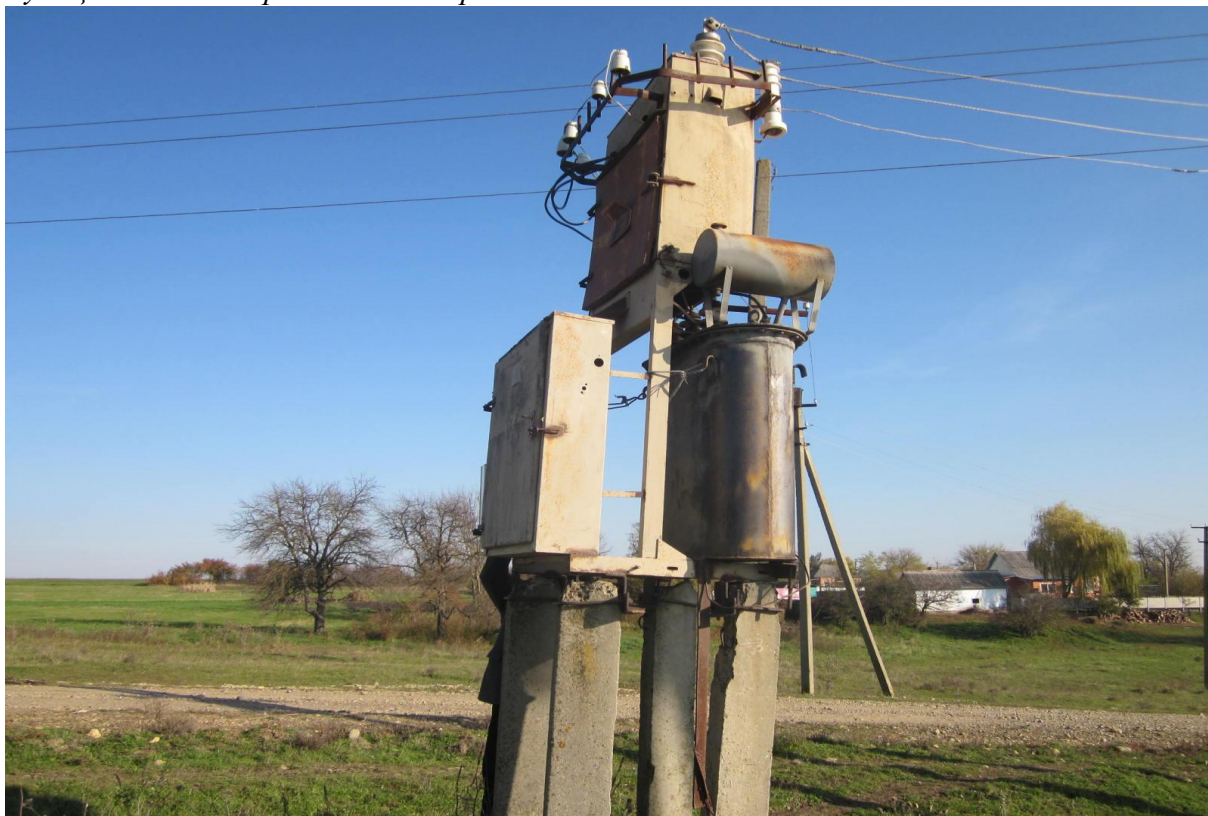
Трансформаторная подстанция – 100 кВт. х.Козопольанский. Трансформатор зарос. Отсутствуют необходимые надписи. Замаслен. Ржавый.
