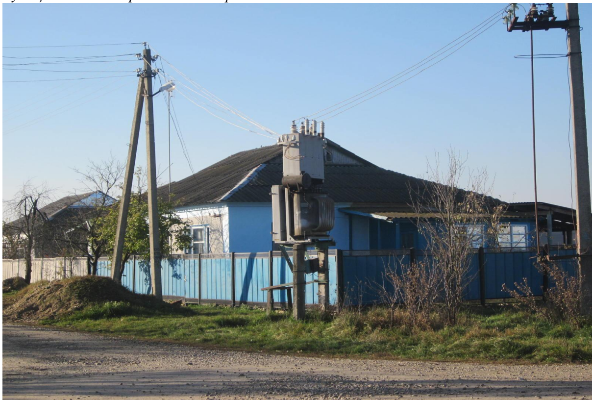
Трансформаторная подстанция -100 кВт. Трансформатор замаслен. Ржавый. Необходимых надписей нет.
