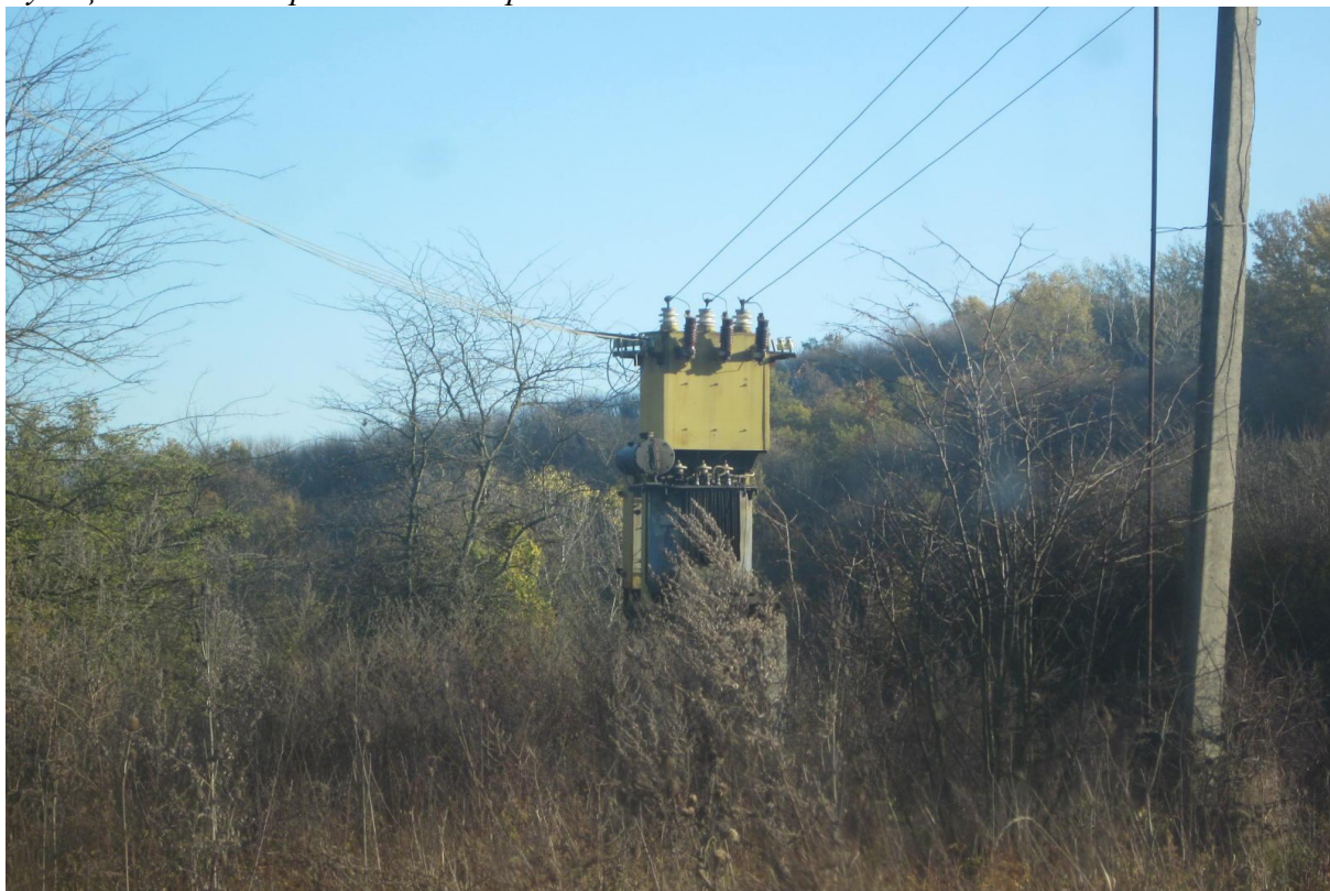
Трансформаторная подстанция – 100 кВт. Трансформатор замаслен. Необходимых надписей нет. Стоит в траве.
