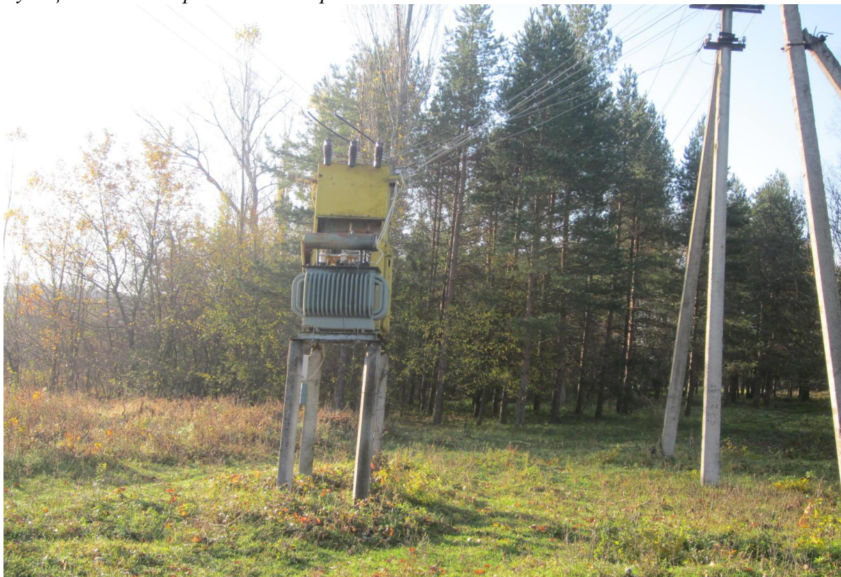
Трансформаторная подстанция -100 кВт. х.Тамбовский. Трансформатор ржавый. Надписи отсутствуют.
