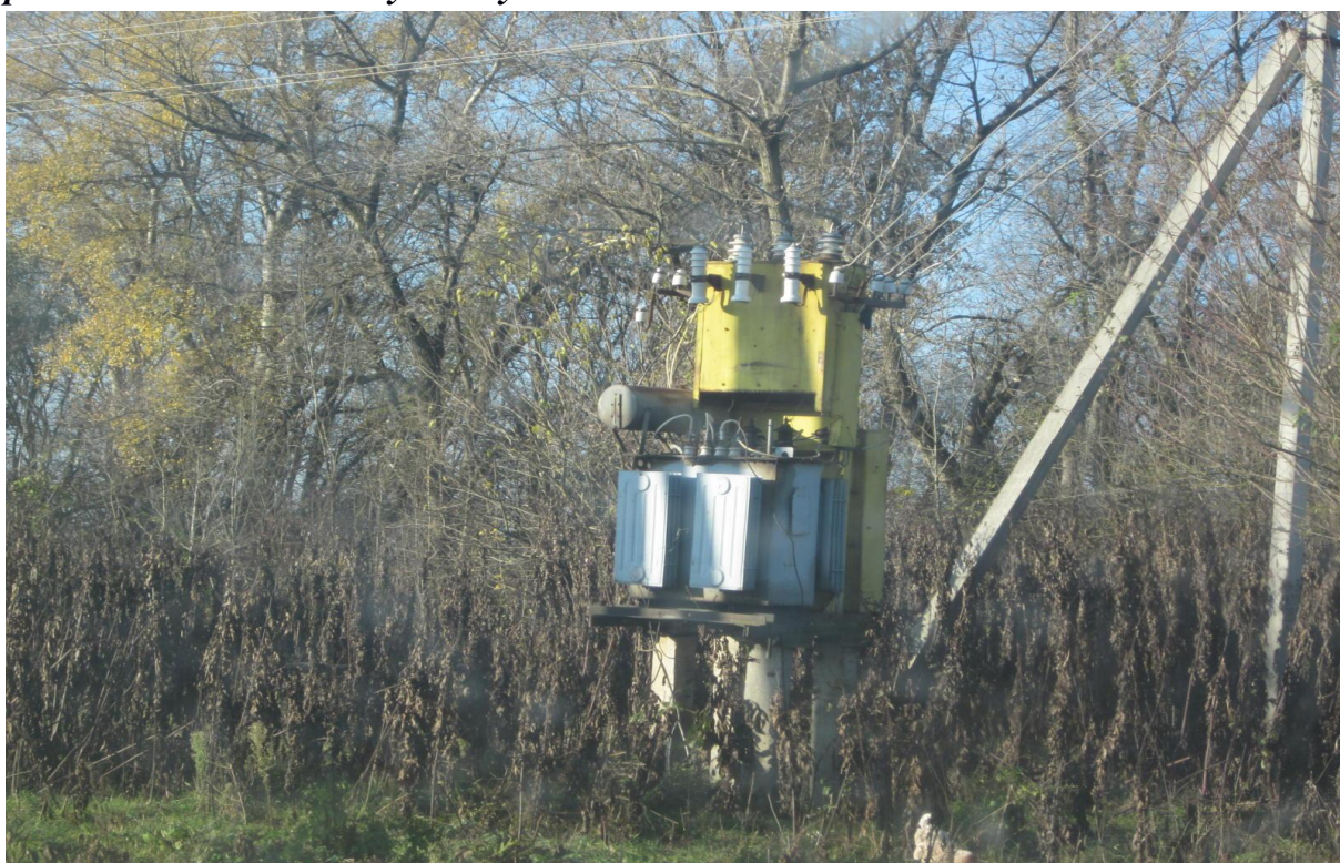
Трансформаторная подстанция – 100 кВт. Отсутствуют необходимые надписи. Трансформатор стоит в траве.
