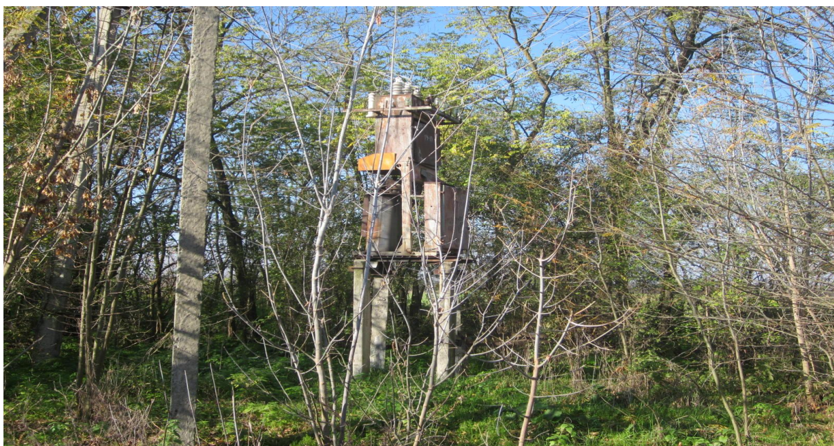
Трансформаторная подстанция – 100 кВт. х.Шишкинский. Трансформатор стоит криво, скоро упадет. Ржавый. Надписей необходимых нет.
