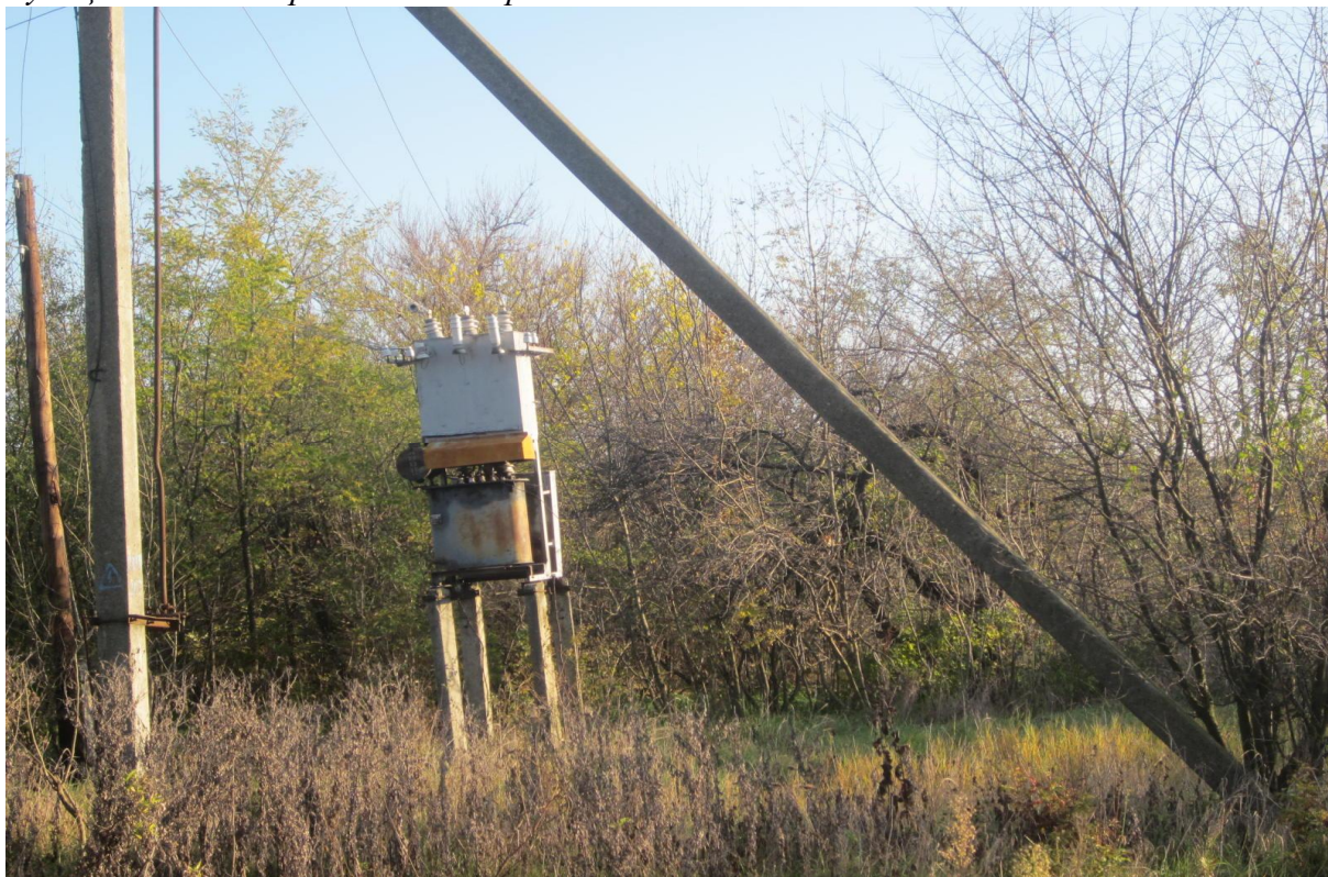
Трансформаторная подстанция – 100 кВт. ул. Северная. Трансформатор замаслен. Нет надписей. Столб деревянный.
