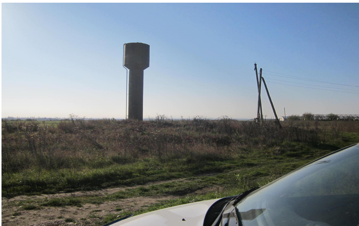
Водонапорная башня. с.Сергиевское. Не соответствует санитарным нормам:СЗЗ нет, башня ржавая. Нет ограждения.
