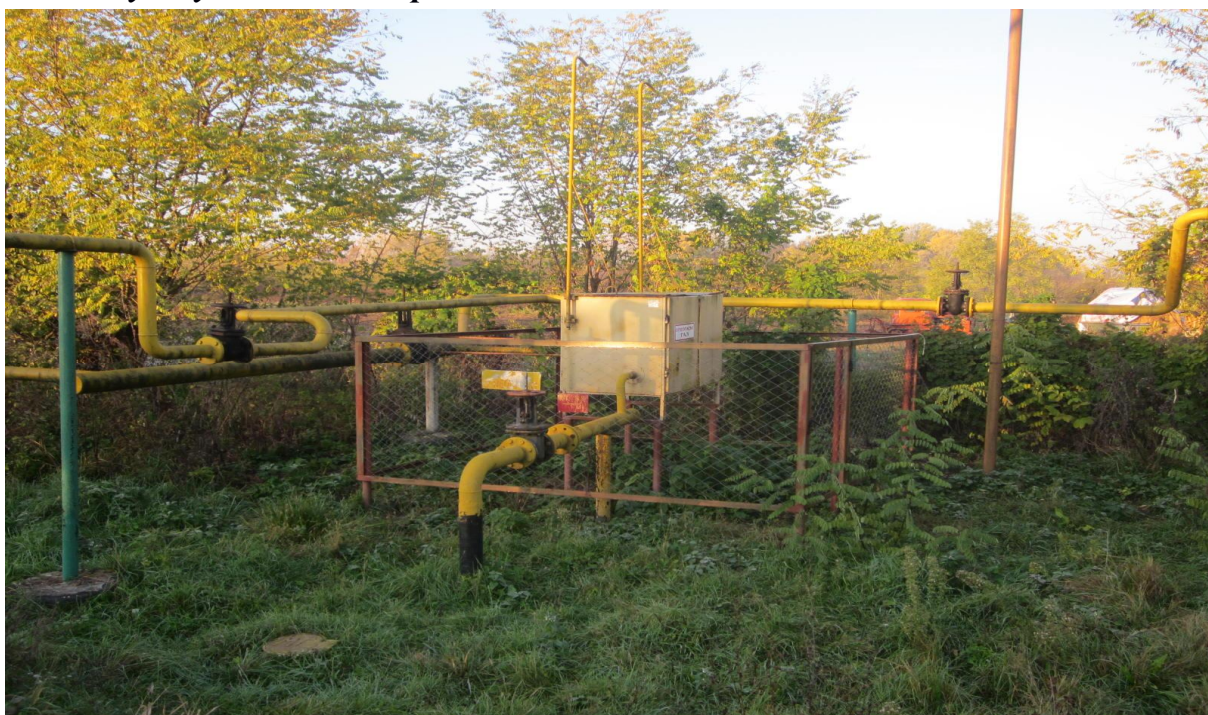
ГРПШ. ул.Пролетарская, 22. Зарос травой. Необходимых надписей нет.
