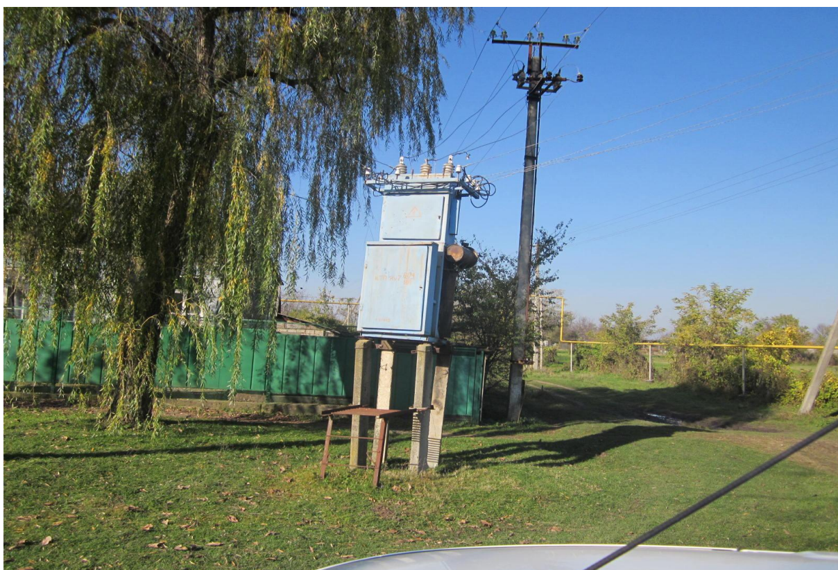
Трансформаторная подстанция – 100 кВт. ул.Центральная, 92. Нет необходимых надписей. Трансформатор замаслен.
