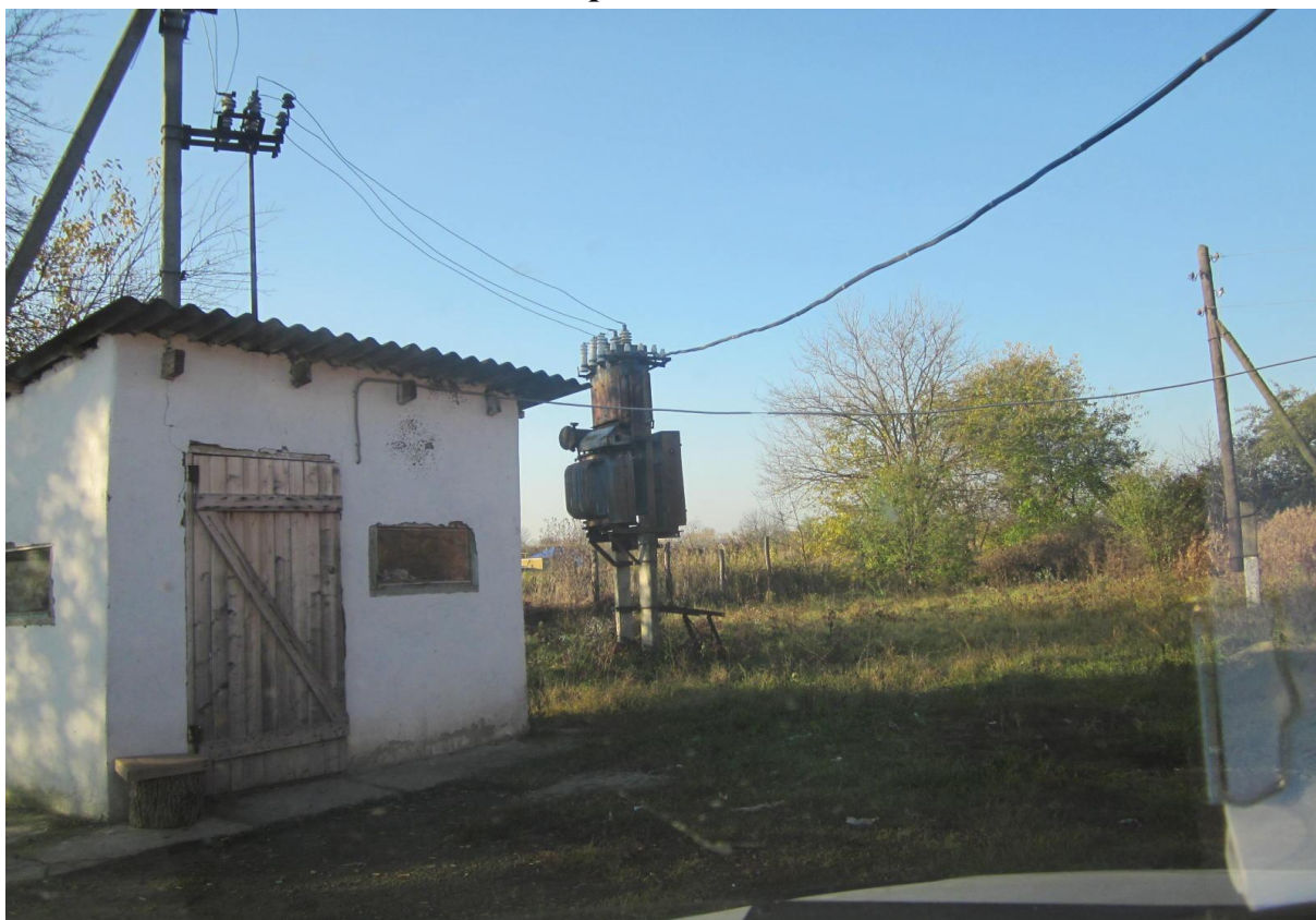
Трансформаторная подстанция – 65 кВт. х. Тамбовский. Трансформатор ржавый. Надписей нет.
