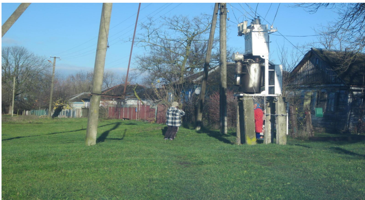
Трансформаторная подстанция – 100 кВт. ст.Келермеская. ул.Прямая. Стоит под углом. Столбы кривые. Разъединители ржавые. Трансформатор замаслен. Столб наклонен.
