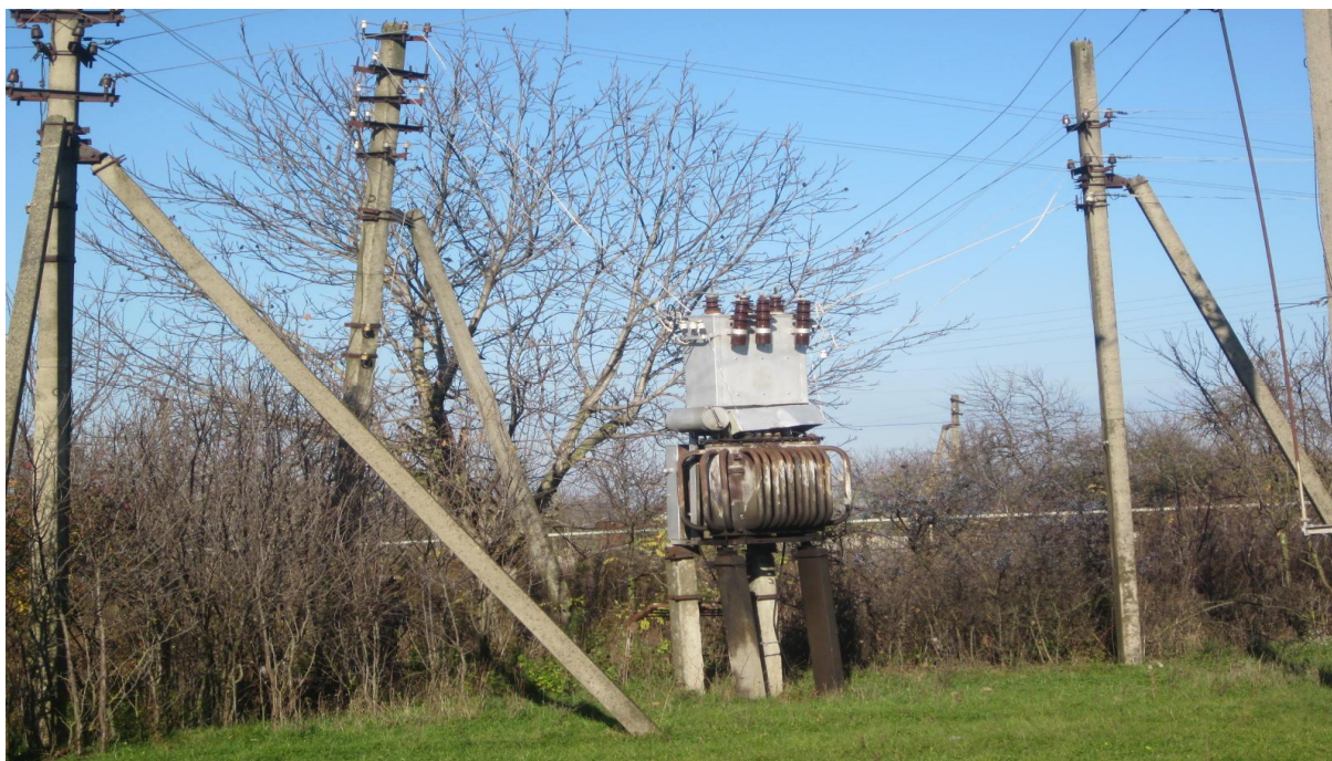
Трансформаторная подстанция – 100 кВт. ст.Келермеская. ул.Восточная и Гвардейская, Мостовая. Трансформатор замаслен. Надписей нет. Все железные узлы сильно ржавые. Изолятор висит.
