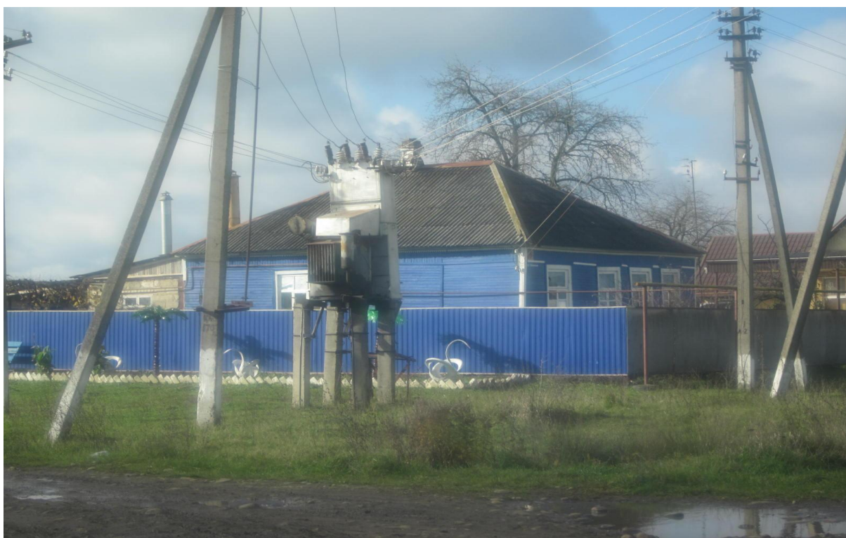
Трансформаторная подстанция – 100 кВт. ст.Келермеская. ул.Колхозная. Трансформатор замаслен. Надписей нет. Скрутки. Разъединители ржавые.
