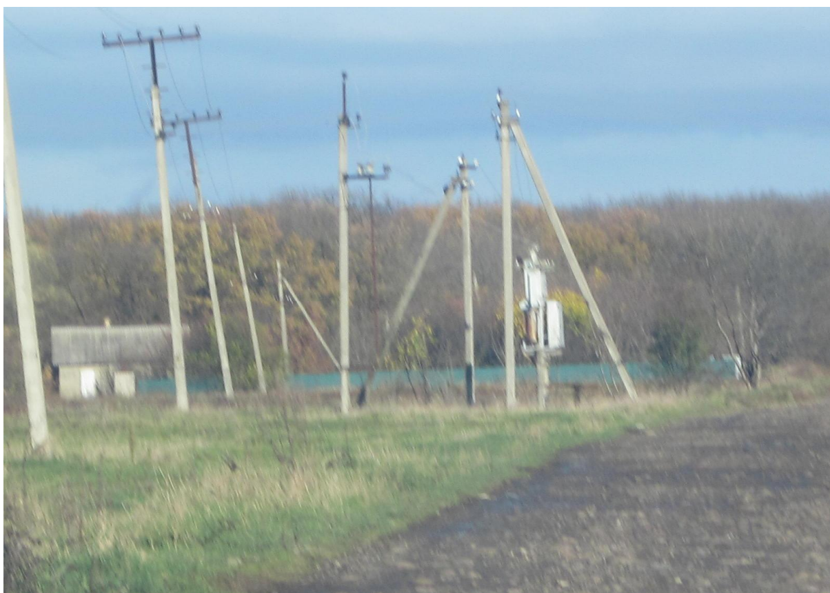
Трансформаторная подстанция – 100 кВт. п.Лесной. Нет надписей.
