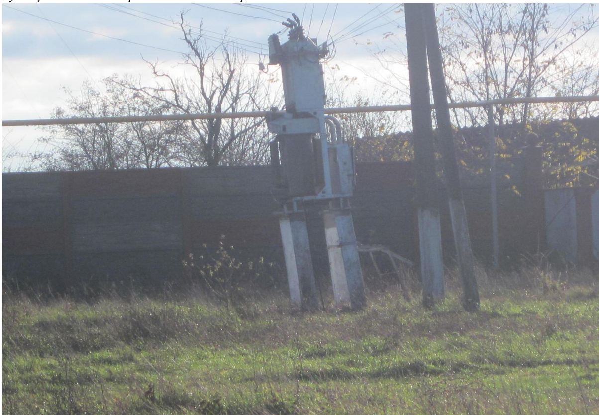
Трансформаторная подстанция – 65 кВт. ст.Келермесская. ул.Ткачева. Стоит под углом 10°. Трансформатор замаслен. Ржавый.
