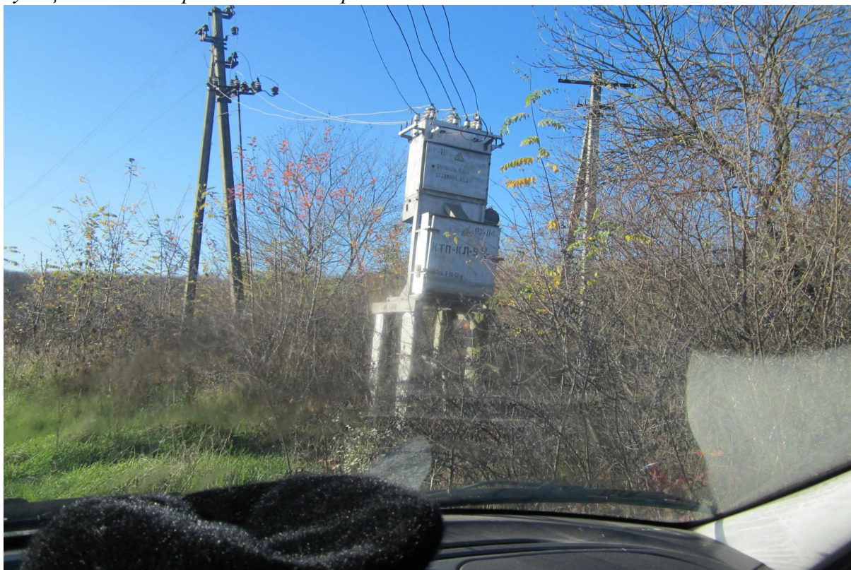
Трансформаторная подстанция – 100 кВт. Нет необходимых надписей. Стоит в кустах. Подвод на скрутках.
