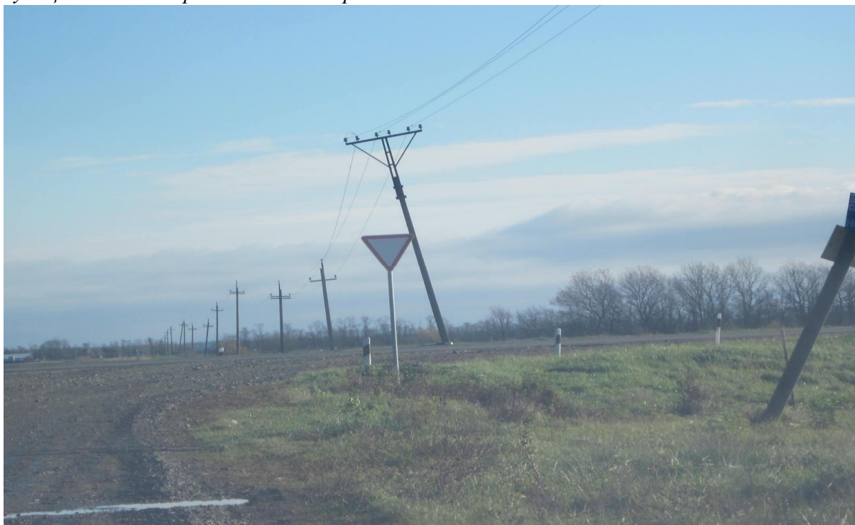
Линия электропередач – 10. Опора стоит под сильным углом. Нет защиты от наезда.
