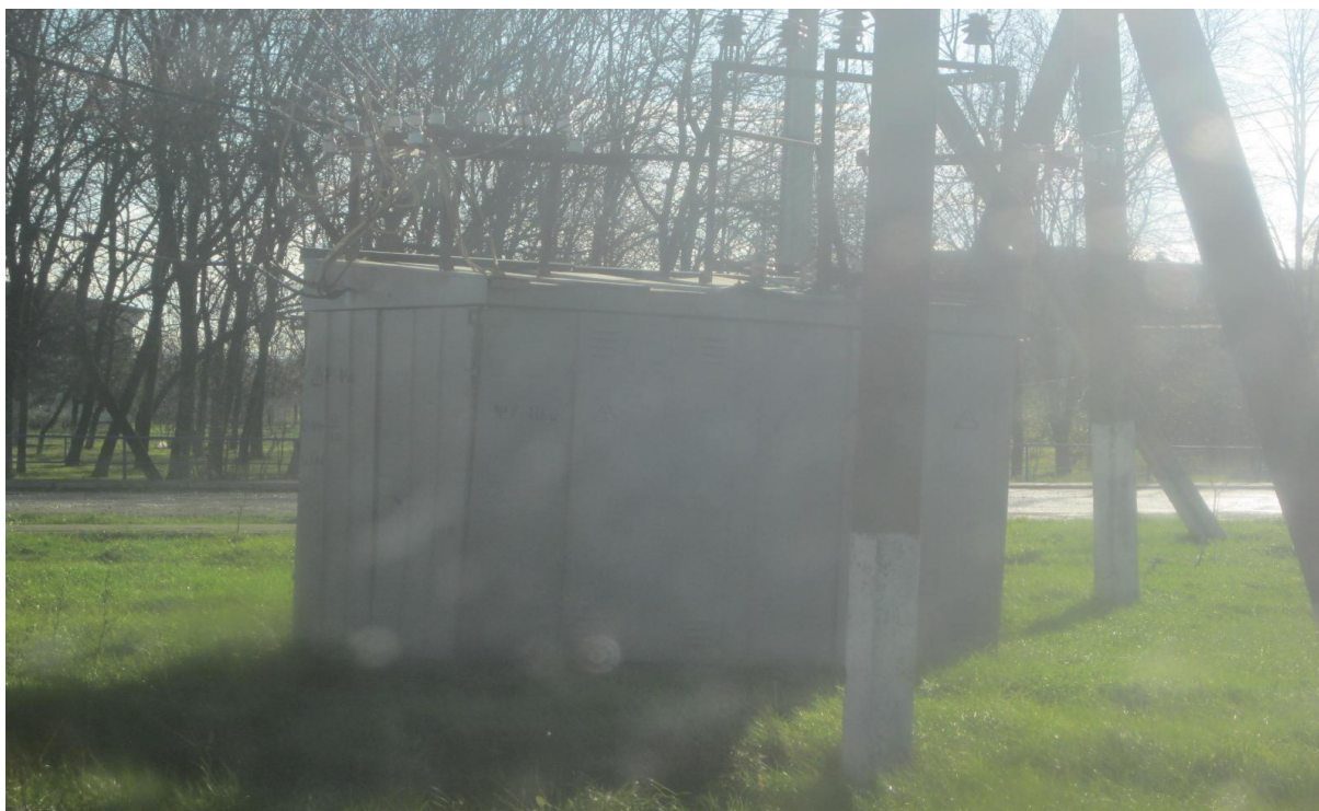
Трансформаторная подстанция – 450 кВт. ст.Келермесская. ул.Октябрьская. Основной источник станции. Нет надписей.
