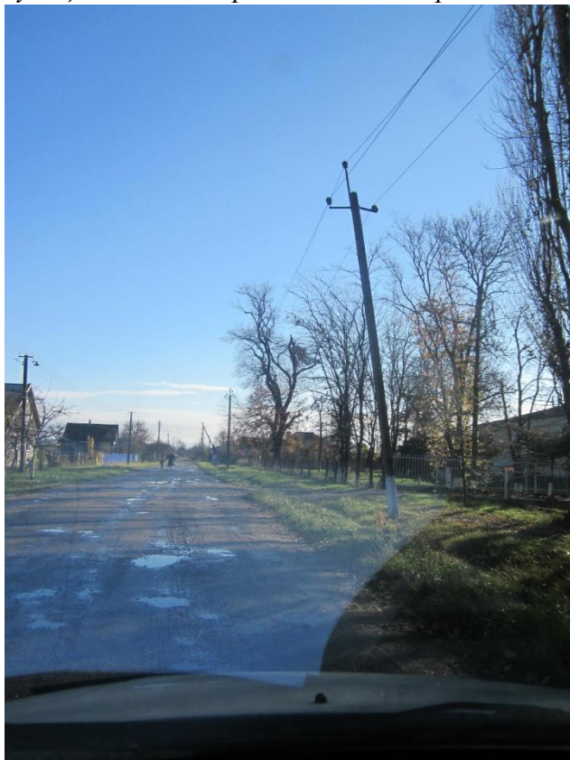
Опора линии электропередач. ст.Келермеская. ул.Октябрьская. Столб стоит под углом, представляет угрозу для жизни людей.
