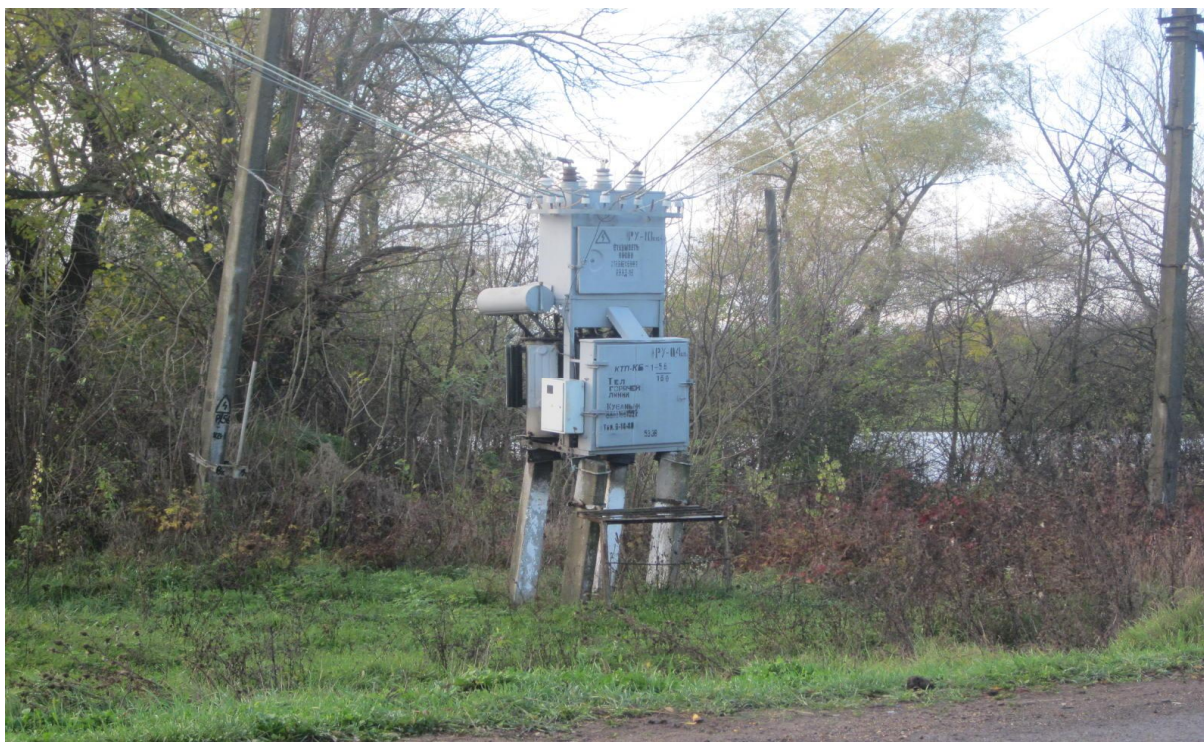
Трансформаторная подстанция – 100 кВт. ст.Келермеская. ул.Мостовая,38. Трансформатор замаслен. Стоит не вертикально. Разъединители ржавые. Столб стоит криво.
