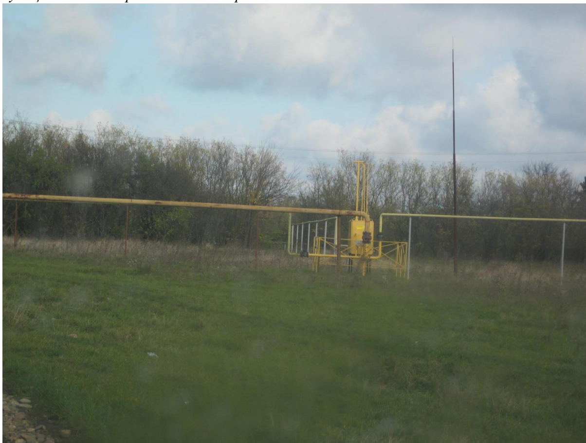
ГРПШ. ст.Келермесская. ул.Широкая.
