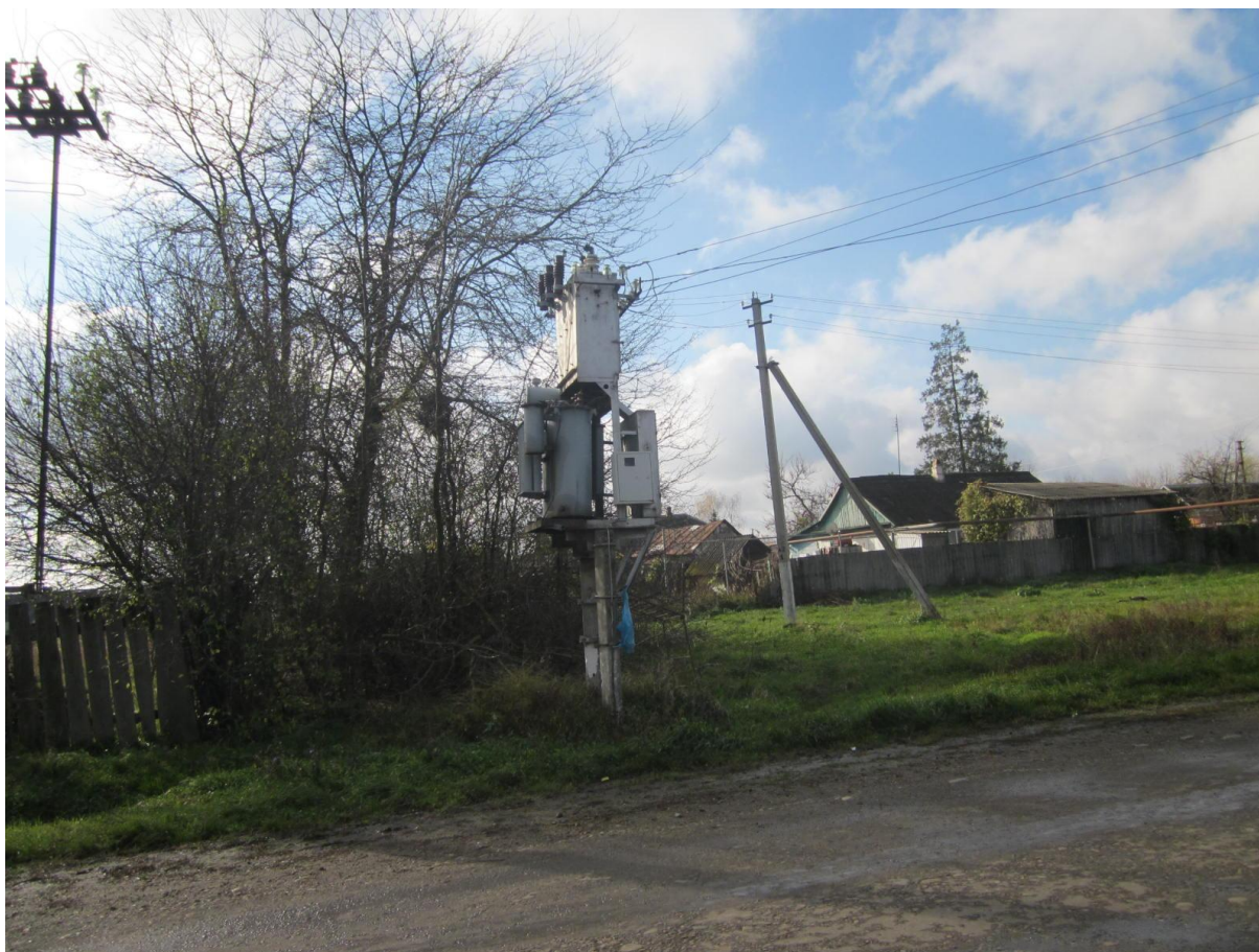
Трансформаторная подстанция – 100 кВт. ст.Келермеская. ул.Советская и Дружбы. Трансформатор замаслен. Скрутки. Надписей нет.
