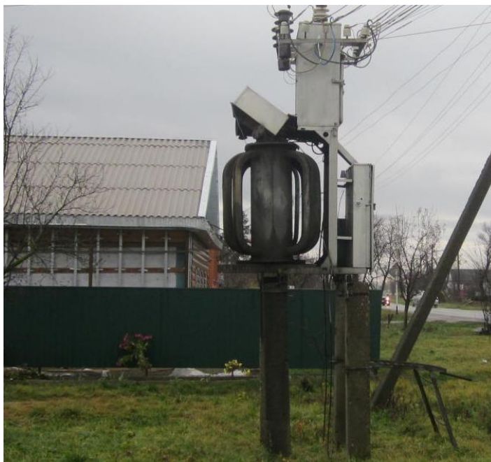
Трансформаторная подстанция – 160 кВт. Разъединитель ржавый. Бандаж ржавый. Трансформатор замаслен. Кожух не правильно установлен. Надписей нет.
