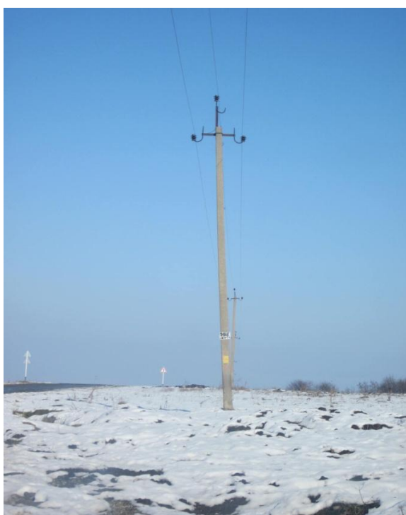
Опора линии электропередач ВВ, надписей нет. Столбы стоят под углами.
