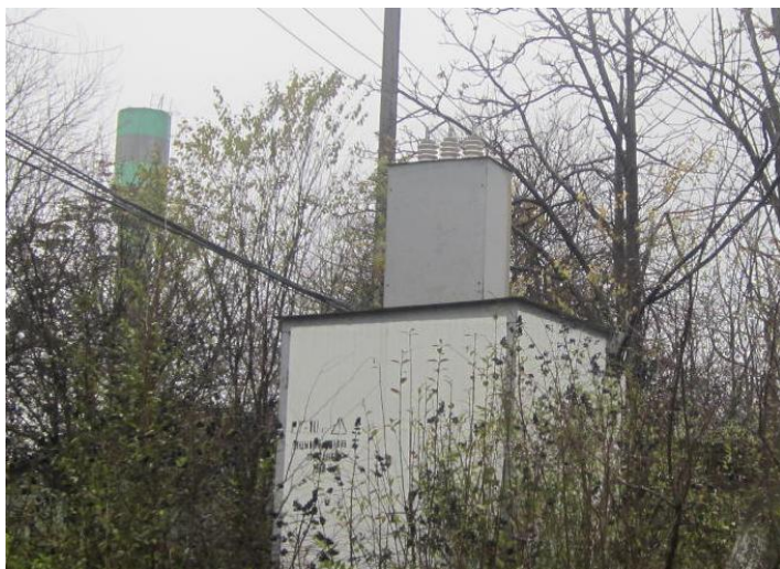
Трансформатор современный но не обслужен. Зарос в траве. Нет надписей.
