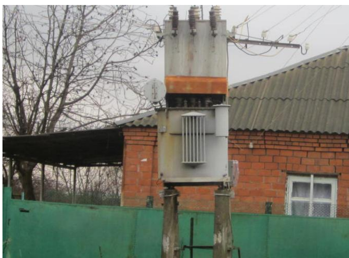
Трансформатор стоит под углом создаёт угрозу жизни населению и дому. Бандажи не покрашены. На проводах скрутки.
