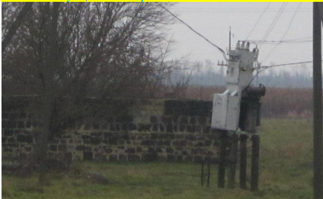
Трансформаторная подстанция – 100 кВт.. Трансформатор ржавый. Замаслен. Надписей нет. Трансформатор сборный
